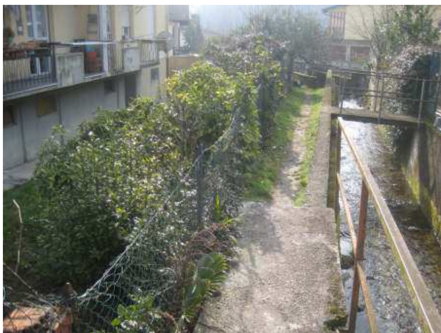
Rio Bacenetto, tratta compresa tra le immissioni dei Rii Riana e Zoncalina: settore con terreni edificati in sinistra idrografica posti ad una quota più bassa rispetto a quelli in destra, e non protetti da un muro in elevazione
