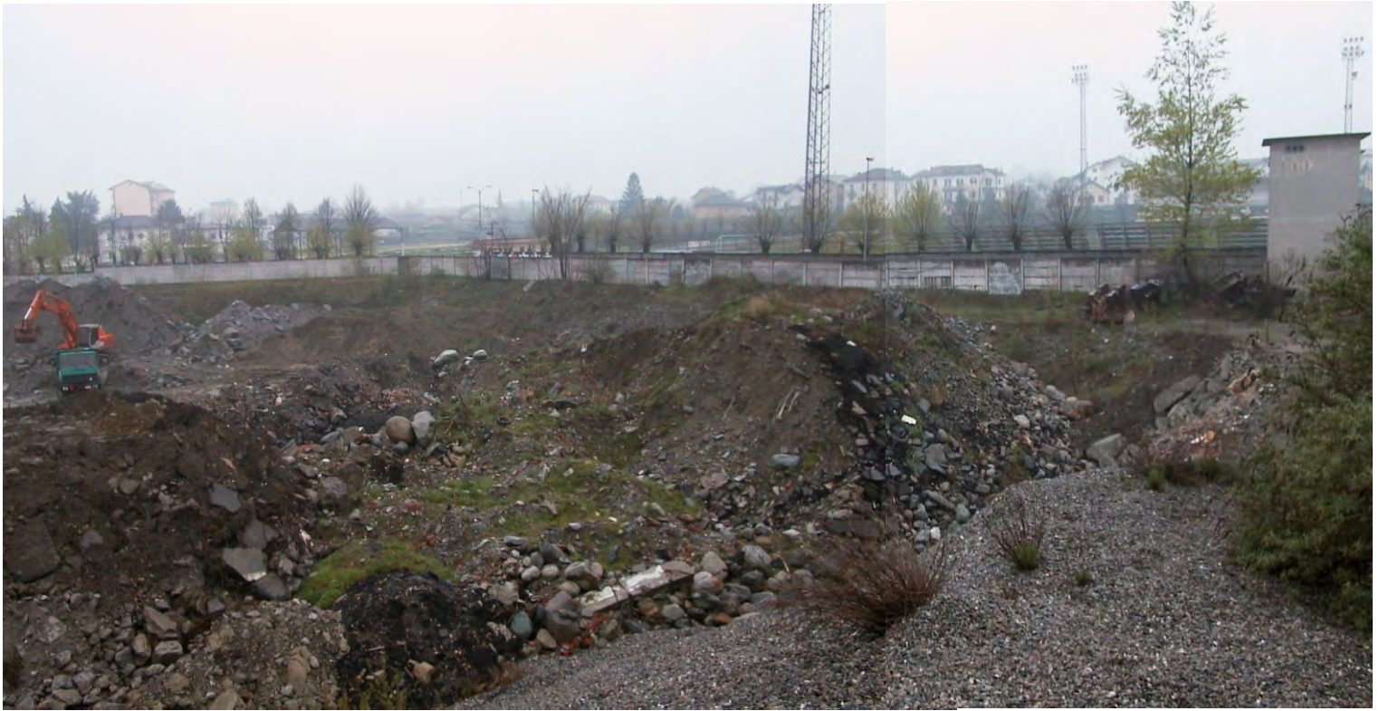
Intervento 12: veduta dell'area posta immediatamente ad a Est del campo sportivo; particolare del settore attualmente interessato da estesi lavori di scavo.
